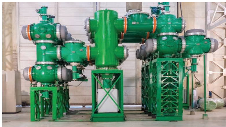
BHEL make 400 kV GIS
